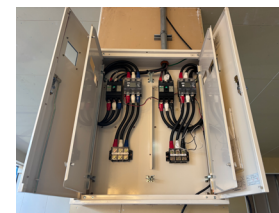
「湘南モールフィル」のテナント部に設置された電力計量器
