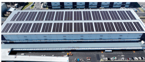
「ロジポート名古屋2」に設置された「DREAM Solar 愛知岩塚」
