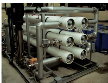
井水浄化装置
