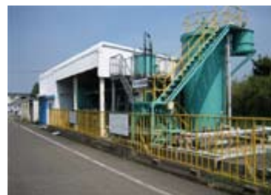
排水処理施設(九州工場)
