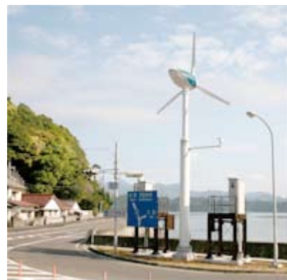
「風流鯨」の設置事例(和歌山県太地町)
