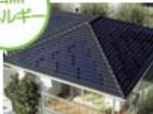
太陽光発電システム
