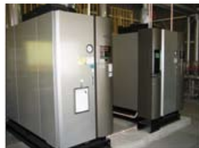
ばい煙発生施設(ボイラー)(九州工場)
