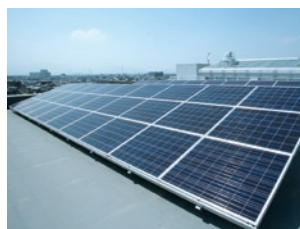
屋上に設置した太陽光発電パネル（11.55kW）
