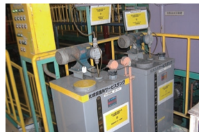
電着塗装施設の有害物質貯蔵タンクへの基準適合表示（新潟工場）
