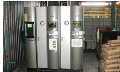
ばい煙発生施設（ボイラー・奈良工場）
