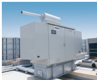
自家発電装置
