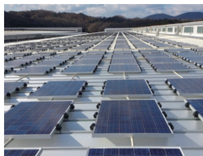
岡山工場(太陽光発電システム0.8MW)
