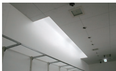
ドラッグストアの壁際に設置した光ダクト
