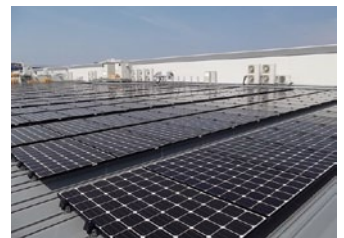
アクロスプラザ森町の太陽光発電設備 (26.5万kWh/年)
