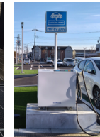
駐車場に設置された EV充電設備
