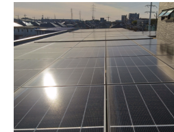
屋上の太陽光発電設備 (31.2kW)
