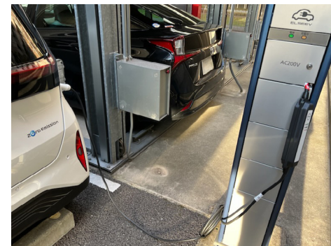
大和ハウス工業神戸支店に設置されている充電設備
